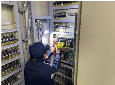
メーカー制御装置 精密検査
